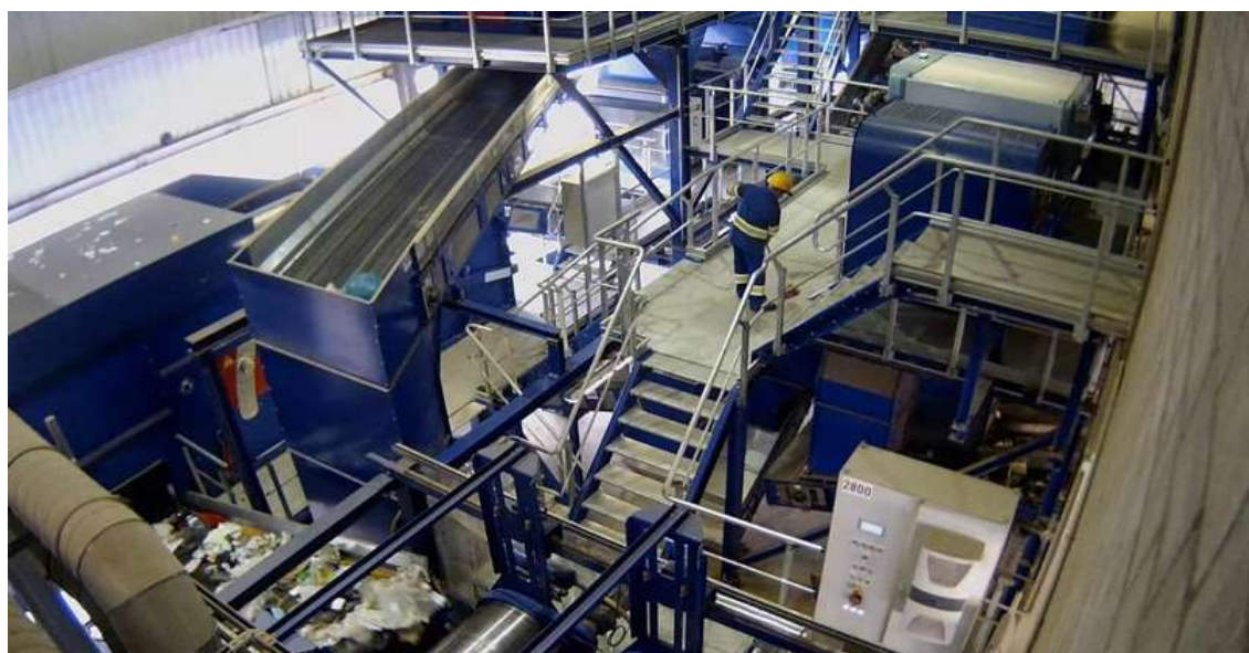
Figura 08 – Imagem da Central Mecanizada de Triagem
