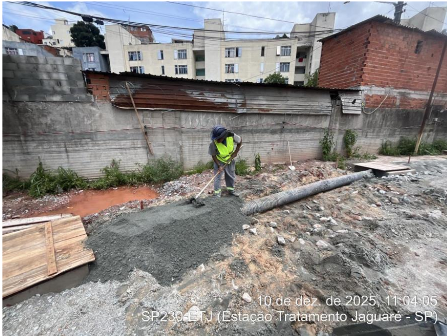
Execução da drenagem pluvial (Escavação, Concretagem, Instalação de tubulação, alvenaria com blocos de concreto da caixa de drenagem pluvial, Execução das tampas das caixas e reboco) – Início em agosto/2025.
