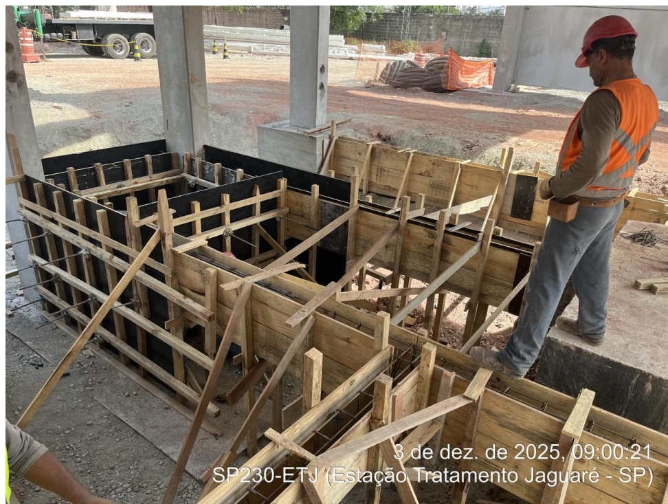
Execução dos blocos de fundação do transbordo (Armação, Concretagem, Desmontagem, Impermeabilização e Demarcação dos eixos) – Início em junho/2025.
