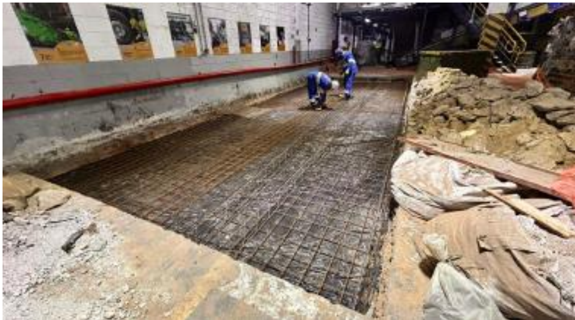
Armação de reforço do trecho do piso reconstruído para a instalação da nova prensa em outubro de 2025.
