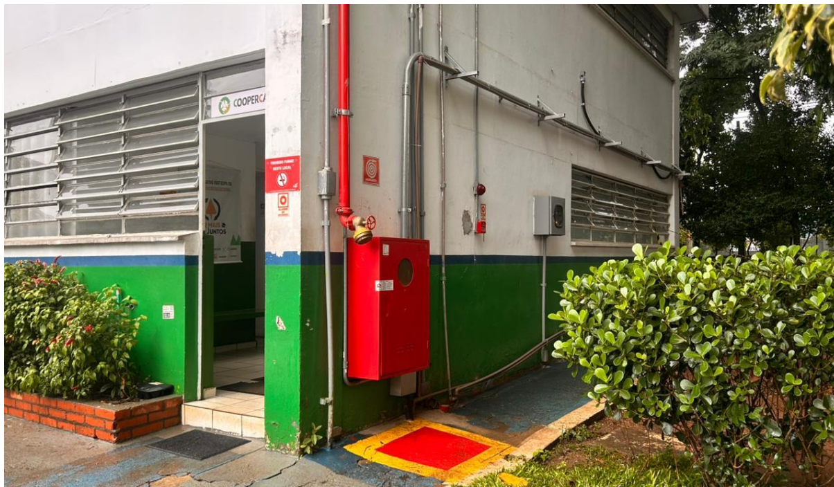
Novo sistema de combate a incêndios instalado na Unidade em novembro de 2025.
