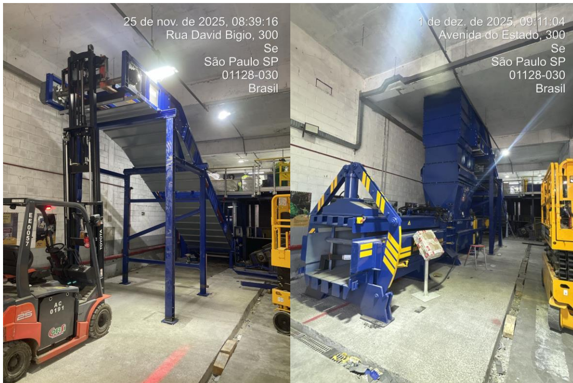
Instalação de correia transportadora de alimentação, equipamento perfurador de garrafas e embalagens e da nova prensa em dezembro de 2025.
