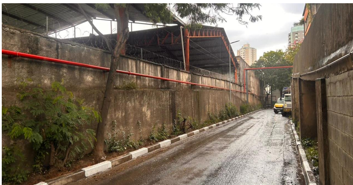
Tubulação do novo sistema de combate a incêndios instalada no mudo da Unidade em novembro de 2025.
