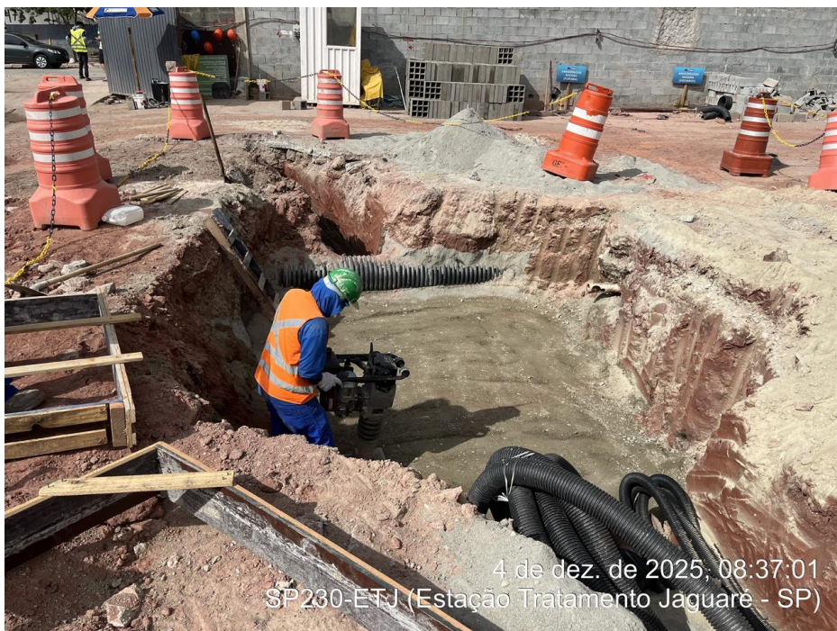
Execução da Drenagem Profunda (Aplicação de brita sobre manta geotêxtil, escavação, instalações hidráulicas e reaterro) – Início em setembro/2025.
